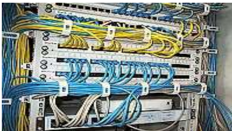
184-rasm. Kommutatsiya paneli ko'rinishi.
