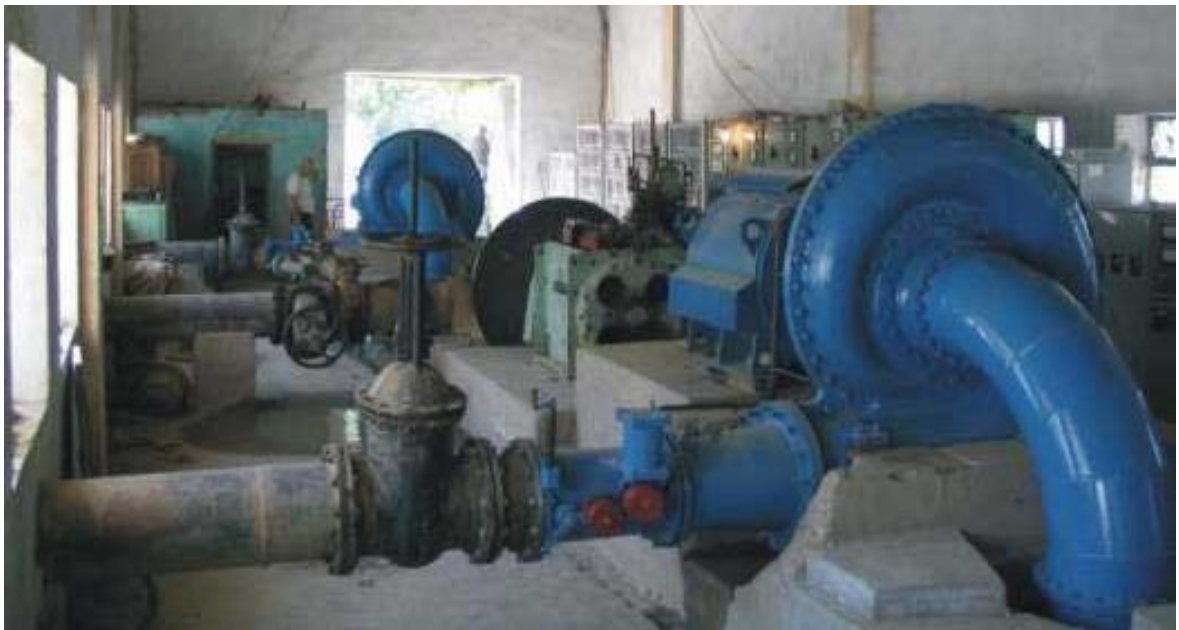
3.11-rasm. Gorizontal radial-o'qiy turbinalar o'rnatilgan kichik GES binosining ko'rinishi.
