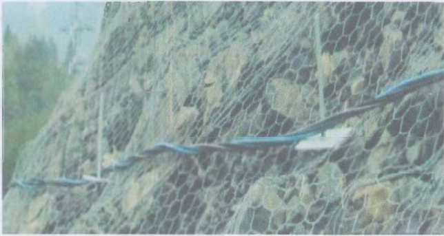
Рис. 3.8. Улавливающие сооружения для защиты от камнепадов
