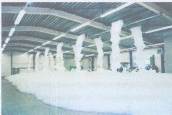
Рис. 4.9. Тестовые испытания спринклерной установки
