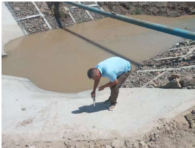
3-расм. Каналдаги бетон қопламаларнинг ҳолати.
